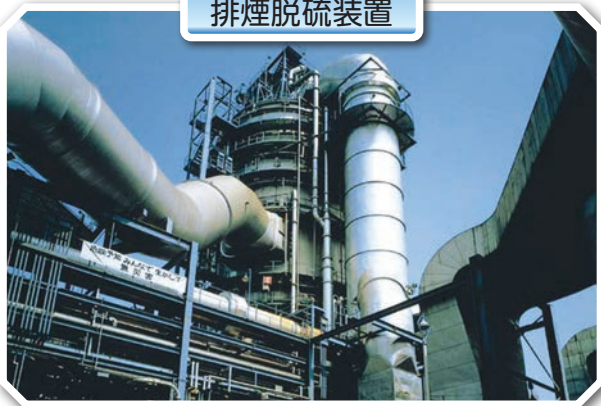
はいえんだつりゅうそうち 排煙脱硫装置
